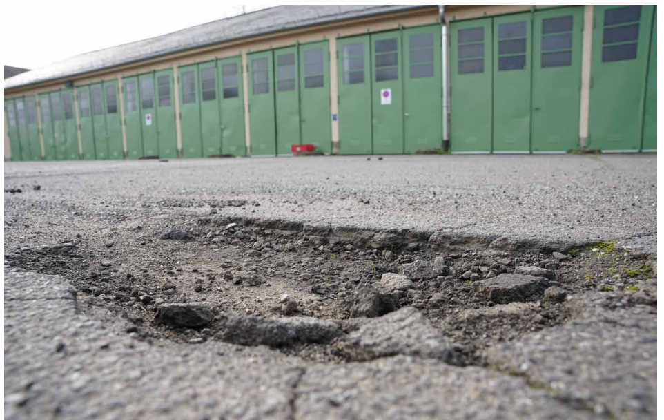
Die Schäden auf der Oberfläche sollen bald der Vergangenheit angehören.
