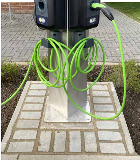
So sehen die Ladesäulen der Firma Wattif aus, die demnächst auch Am Exer aufgestellt werden. Je Säule haben zwei Fahrzeuge Platz.
