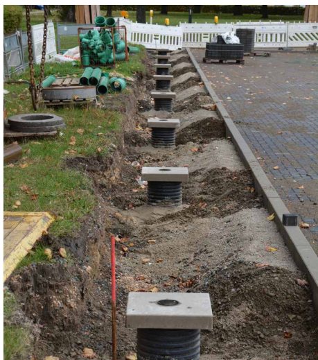
Acht Fundamente für Ladesäulen sind schon gesetzt vor dem Gebäude AE10. Zunächst werden aber nur drei Säulen installiert.
